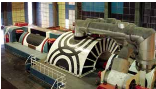
Central Termoeléctrica de Aboño
